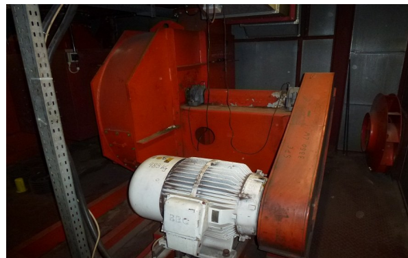
↑ Hallenabsaugung in Lüftungsanlage
